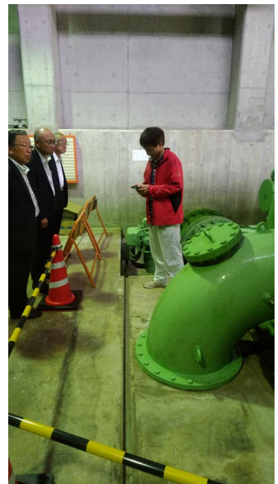
土地改良区連合の発電所にて (10月3日)
